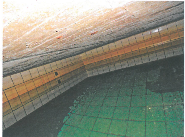
照片 2：蓄水池內部髒污情形
