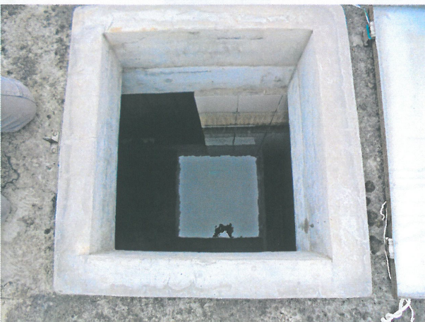
照片 5：頂樓水塔梯口髒污情形
