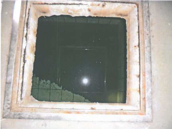
照片 1：蓄水池梯口髒污情形
