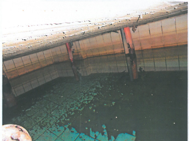
照片 4：消防蓄水池內部髒污情形
