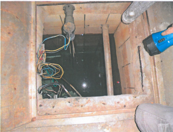
照片 3：消防蓄水池梯口髒污情形
